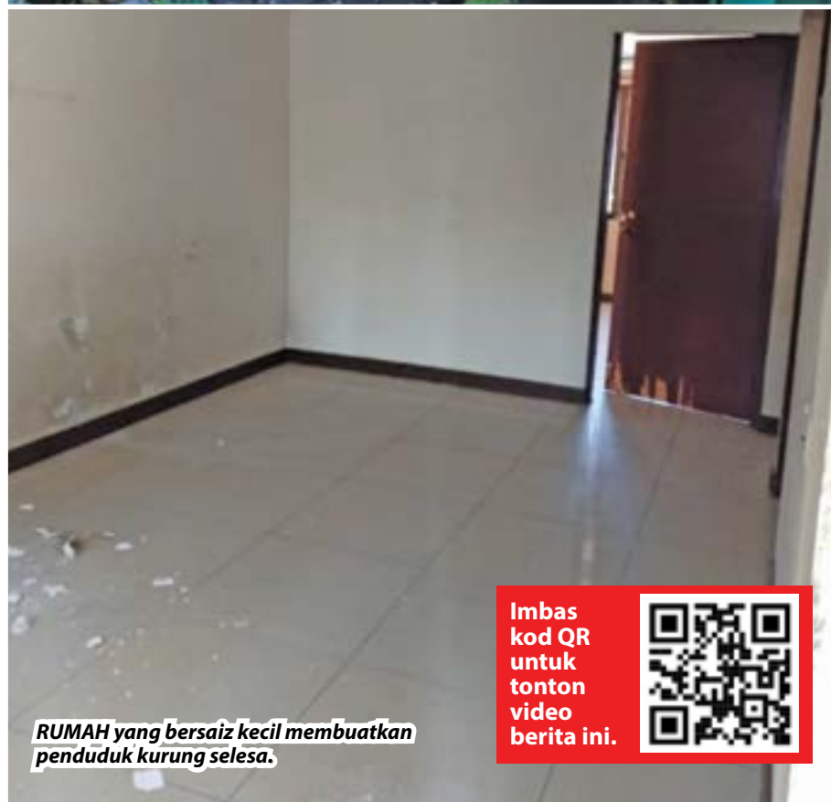
KEADAAN rumah di Pangsapuri Kampung Sungai Baru kelihatan usang dan membimbangkan.
